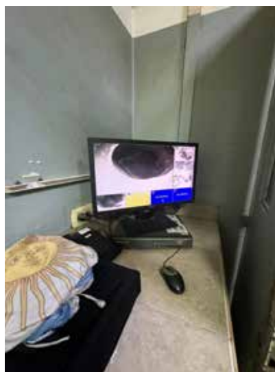
Circuito de cámaras CV 8A
