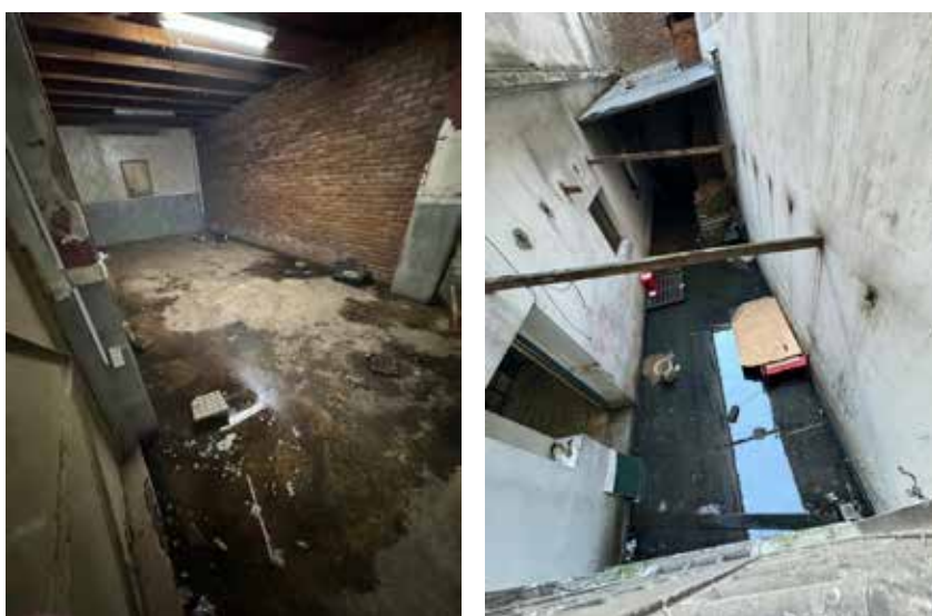
Espacios inundados en CV 3C Anexo
