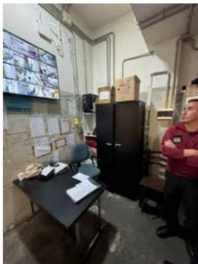
Circuito de cámaras CV 1B
